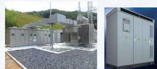
太陽光発電システム
