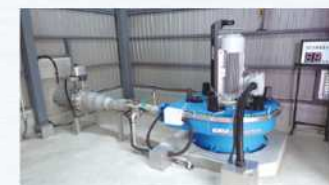
小水力発電システム
