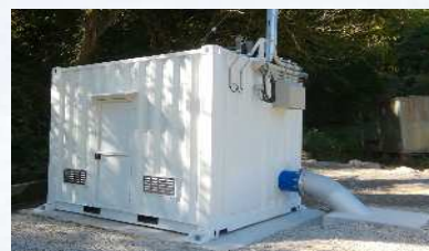
コンパクト小水力発電システム
