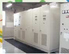
照明制御受変電システム
