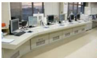
浄水場監視制御システム
