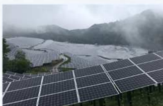
太陽光発電システム
