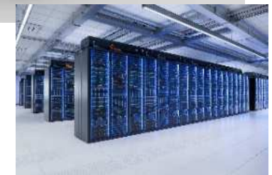
データセンター
