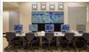
下水処理監視制御システム
