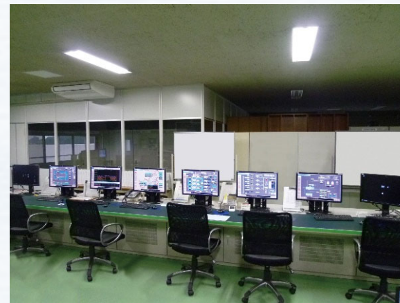
下水処理監視制御システム
