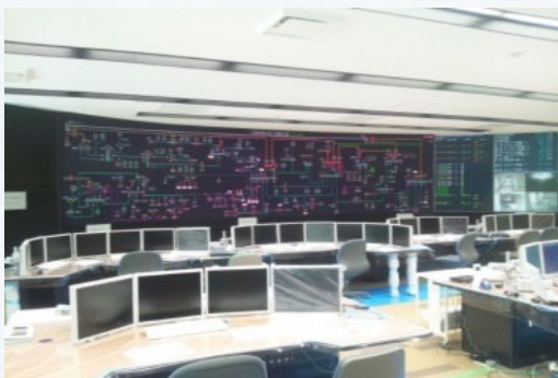
系統給電制御所システム
